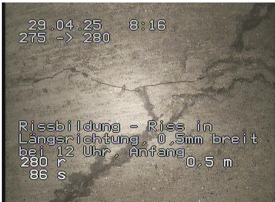
275-280_409.jpg, 00:00:24, 0.50m Rissbildung - Riss in Längsrichtung, 0,5mm breit bei 12 Uhr, Anfang
