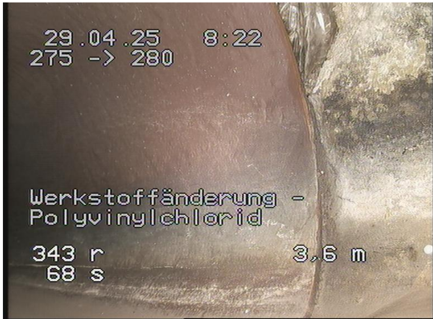
275-280_414.jpg, 00:03:53, 3.60m Werkstoffänderung - Polyvinylchlorid
