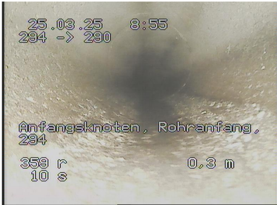
294-290_164.jpg, 00:00:00, 0.00m Anfangsknoten, Rohranfang, 294
