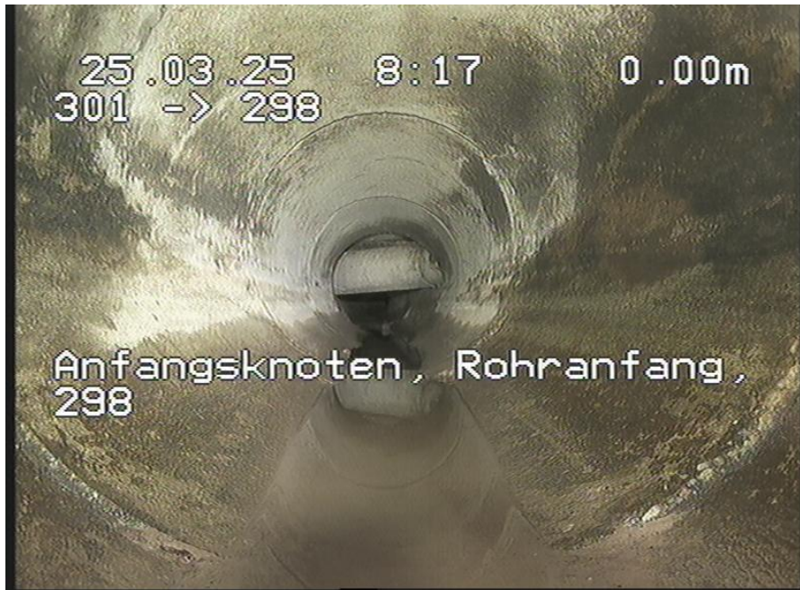
301-298_147.jpg, 00:00:00, 0.00m Anfangsknoten, Rohranfang, 298
