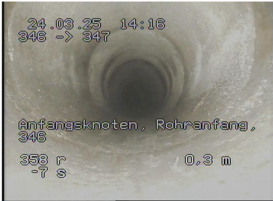
346-347_113.jpg, 00:00:00, 0.00m Anfangsknoten, Rohranfang, 346
