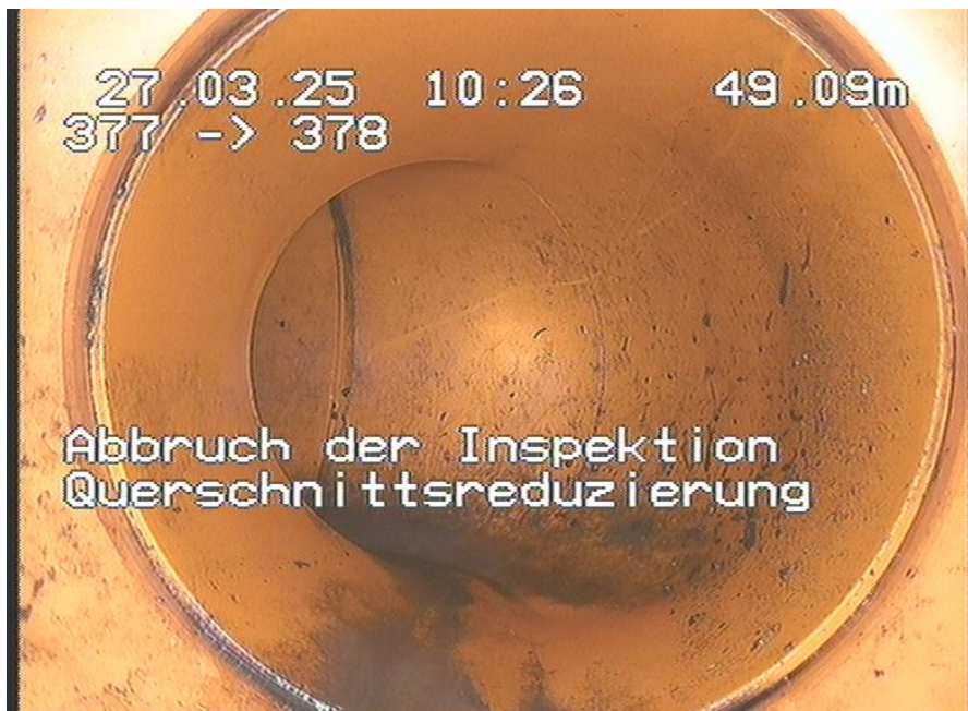
377-378_370.jpg, 00:04:48, 49.09m Abbruch der Inspektion / Querschnittsreduzierung
