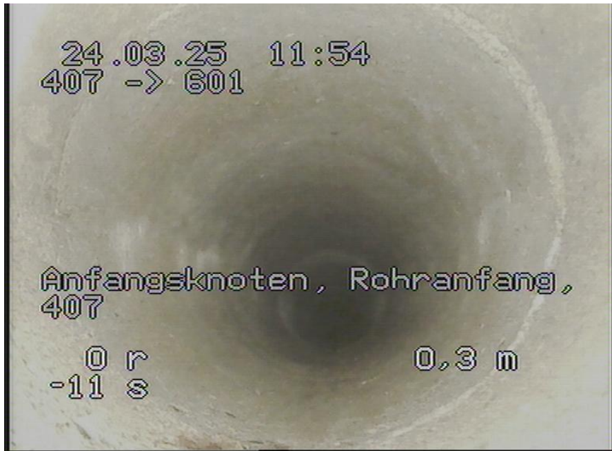
407-601_70.jpg, 00:00:00, 0.00m Anfangsknoten, Rohranfang, 407
