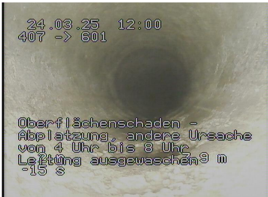
407-601_71.jpg, 00:01:55, 7.90m Oberflächenschaden - Abplatzung, andere Ursache von 4 Uhr bis 8 Uhr / Leitung ausgewaschen
