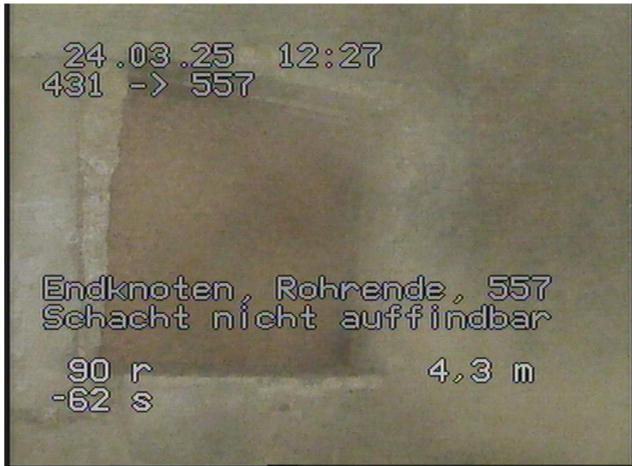
431-557_75.jpg, 00:01:09, 4.30m Endknoten, Rohrende, 557 / Schacht nicht auffindbar
