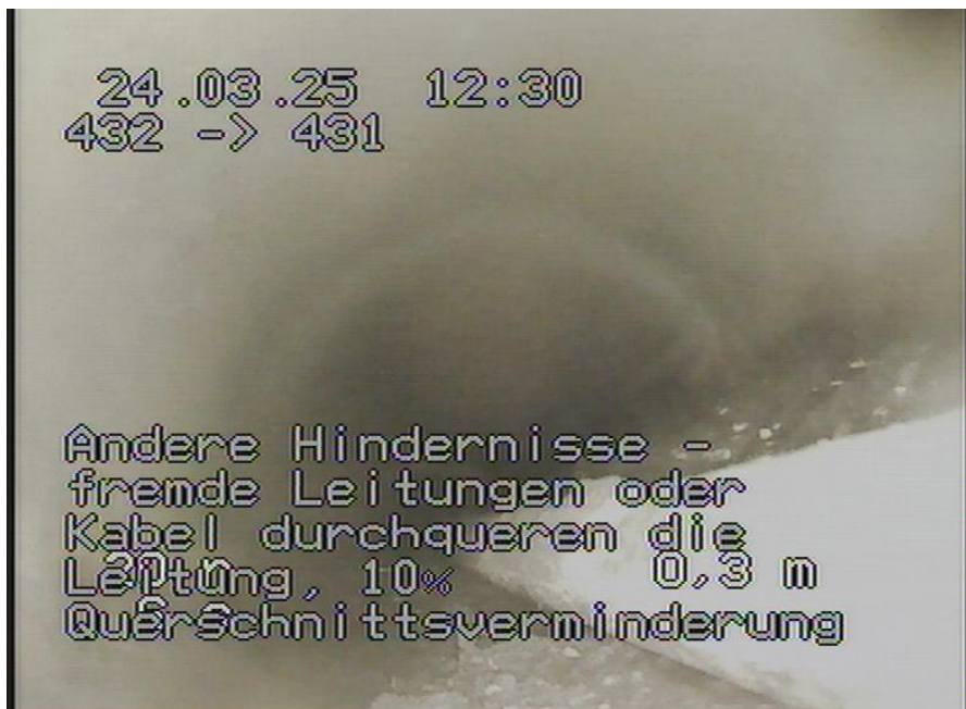
432-431_77.jpg, 00:00:04, 0.01m Andere Hindernisse - fremde Leitungen oder Kabel durchqueren die Leitung, 10% Querschnittsverminderung bei 6 Uhr, Anfang
