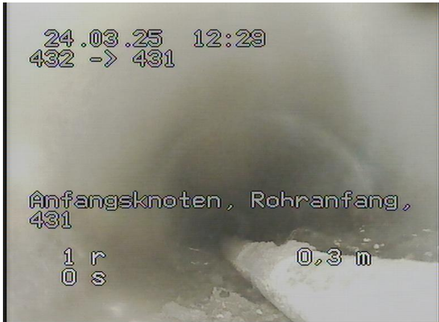
432-431_76.jpg, 00:00:00, 0.00m Anfangsknoten, Rohranfang, 431
