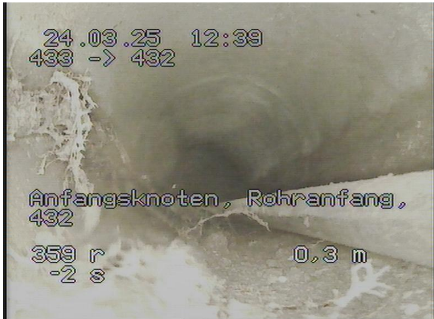
433-432_81.jpg, 00:00:00, 0.00m Anfangsknoten, Rohranfang, 432
