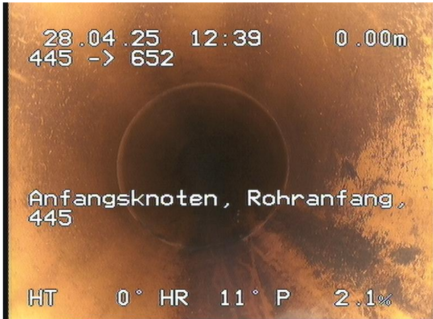
445-652_393.jpg, 00:00:00, 0.00m Anfangsknoten, Rohranfang, 445
