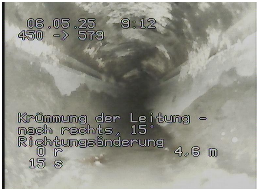
450-579_532.jpg, 00:00:48, 4.60m Krümmung der Leitung - nach rechts, 15° Richtungsänderung
