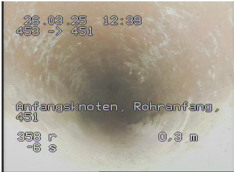
453-451_283.jpg, 00:00:00, 0.00m Anfangsknoten, Rohranfang, 451
