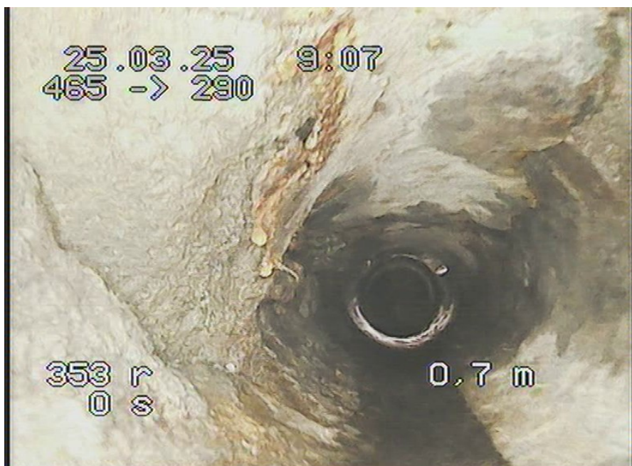
465-290_169.jpg, 00:00:17, 0.70m Rohrbruch/Einsturz - Bruch ohne fehlende Teile, Länge: 150mm von 7 Uhr bis 12 Uhr
