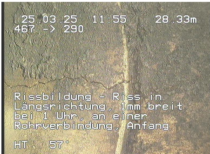
467-290_232.jpg, 00:01:15, 28.33m Rissbildung - Riss in Längsrichtung, 1mm breit bei 1 Uhr, an einer Rohrverbindung, Anfang
