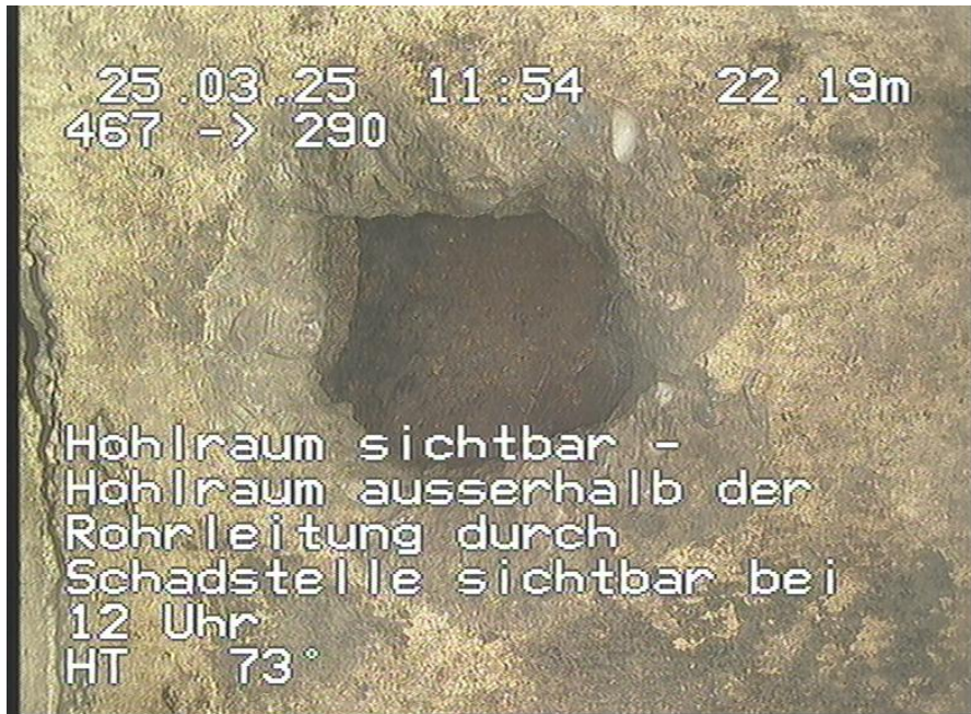
467-290_231.jpg, 00:01:15, 22.19m Hohlraum sichtbar - Hohlraum ausserhalb der Rohrleitung durch Schadstelle sichtbar bei 12 Uhr
