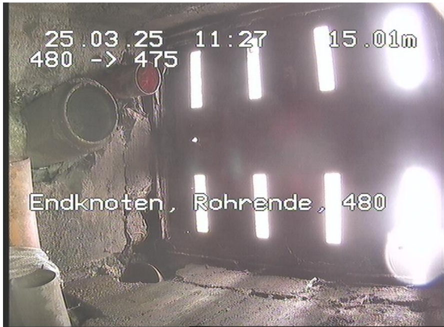
480-475_214.jpg, 00:02:20, 15.01m Endknoten, Rohrende, 480
