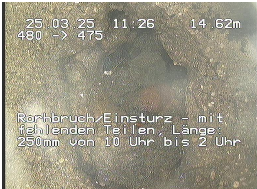
480-475_213.jpg, 00:01:53, 14.62m Rohrbruch/Einsturz - mit fehlenden Teilen, Länge: 250mm von 10 Uhr bis 2 Uhr
