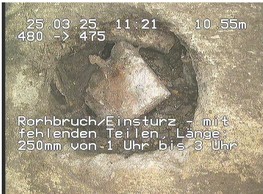
480-475_211.jpg, 00:00:53, 10.55m Rohrbruch/Einsturz - mit fehlenden Teilen, Länge: 250mm von 1 Uhr bis 3 Uhr
