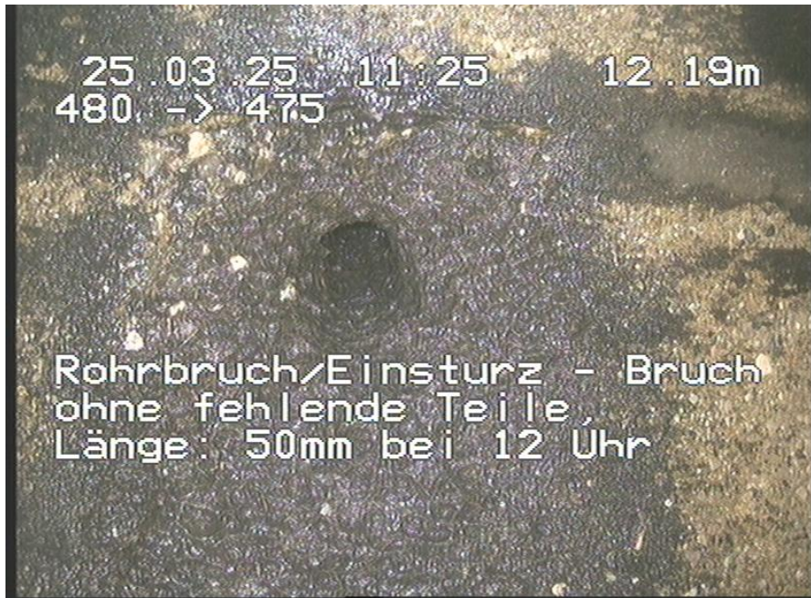
480-475_212.jpg, 00:01:22, 12.19m Rohrbruch/Einsturz - Bruch ohne fehlende Teile, Länge: 50mm bei 12 Uhr
