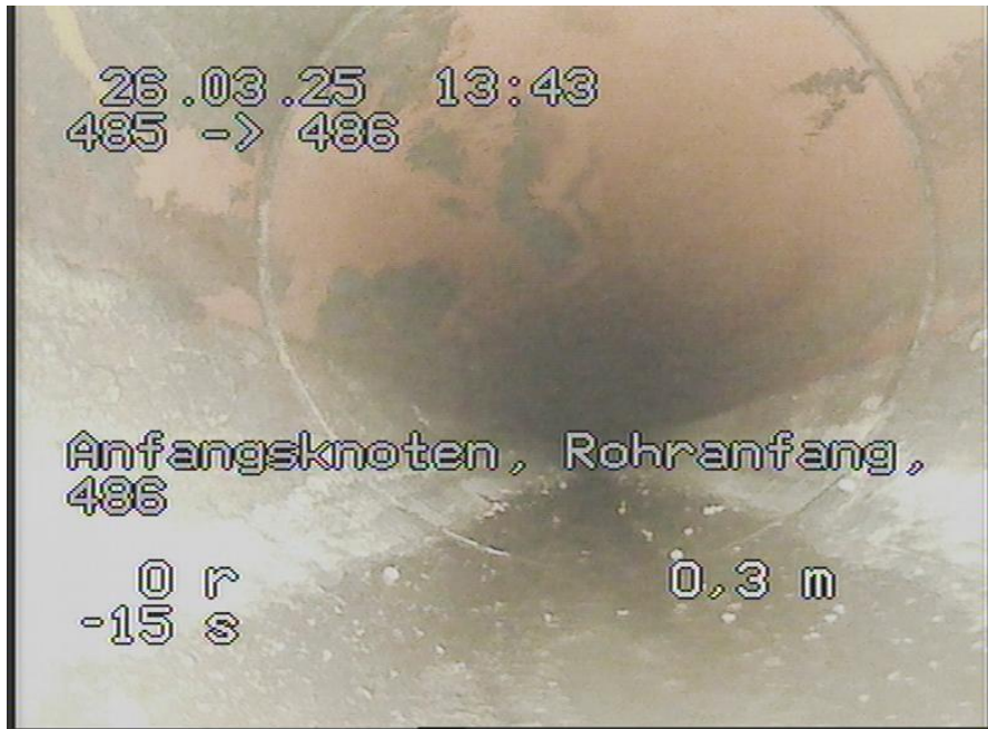
485-486_303.jpg, 00:00:00, 0.00m Anfangsknoten, Rohranfang, 486
