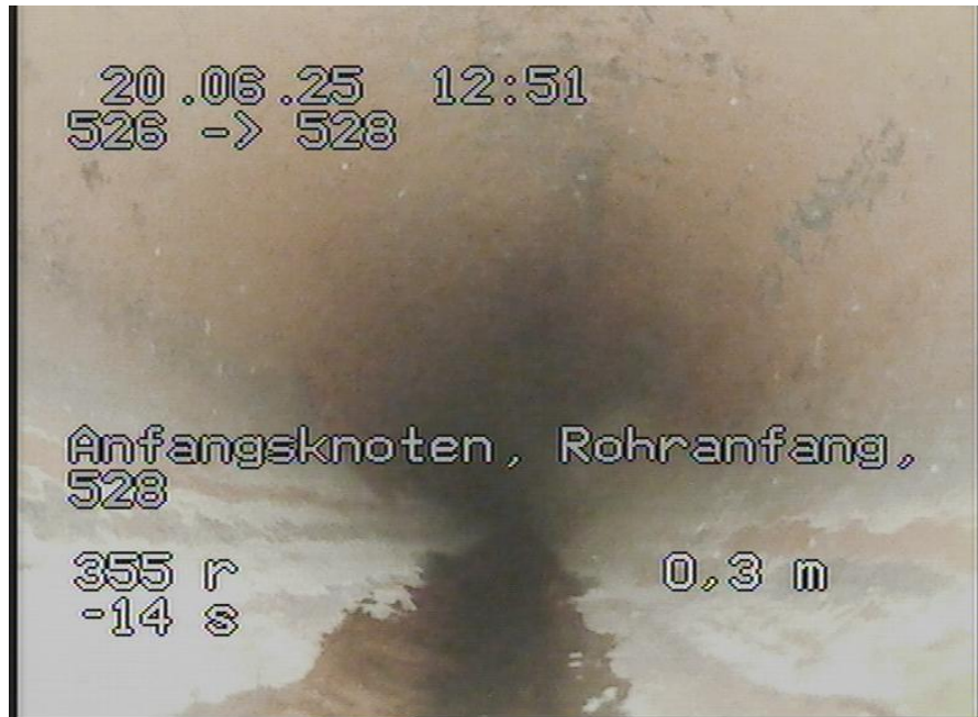
526-528_700.jpg, 00:00:00, 0.00m Anfangsknoten, Rohranfang, 528
