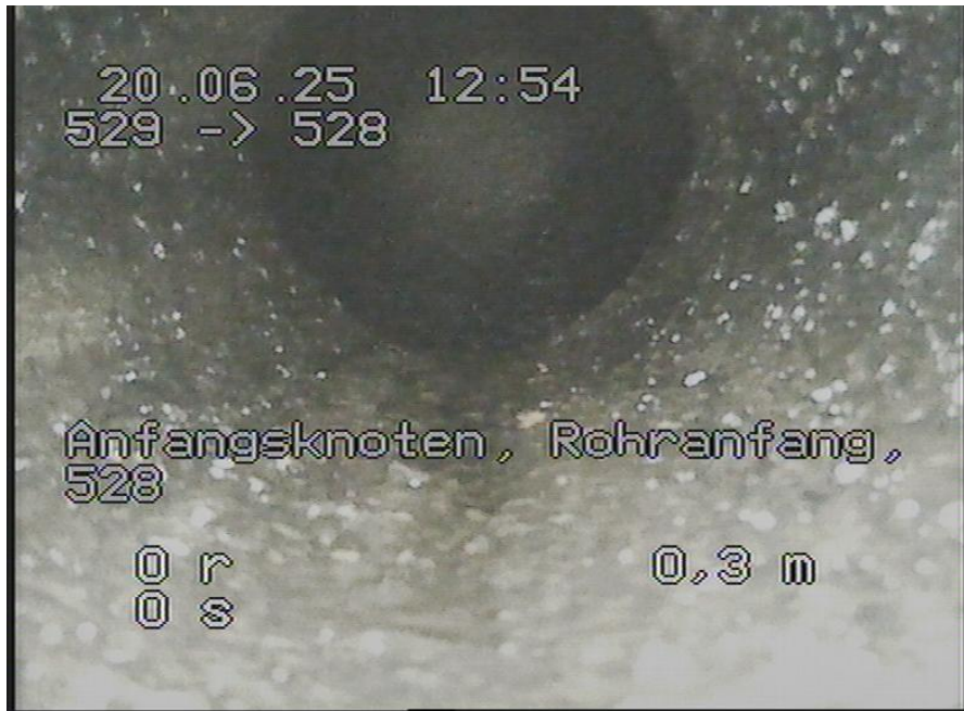
529-528_702.jpg, 00:00:00, 0.00m Anfangsknoten, Rohranfang, 528
