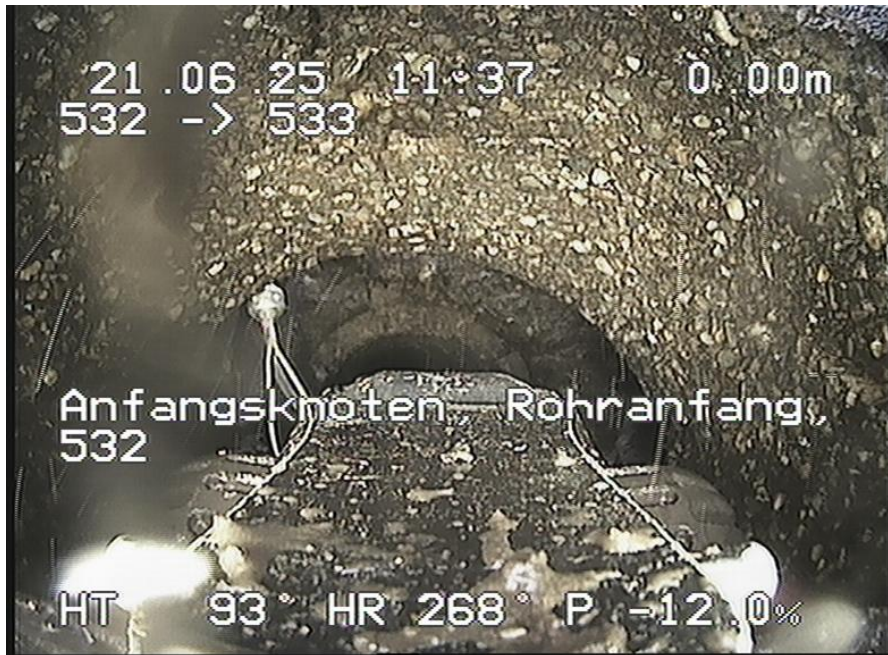
532-533_740.jpg, 00:00:00, 0.00m Anfangsknoten, Rohranfang, 532
