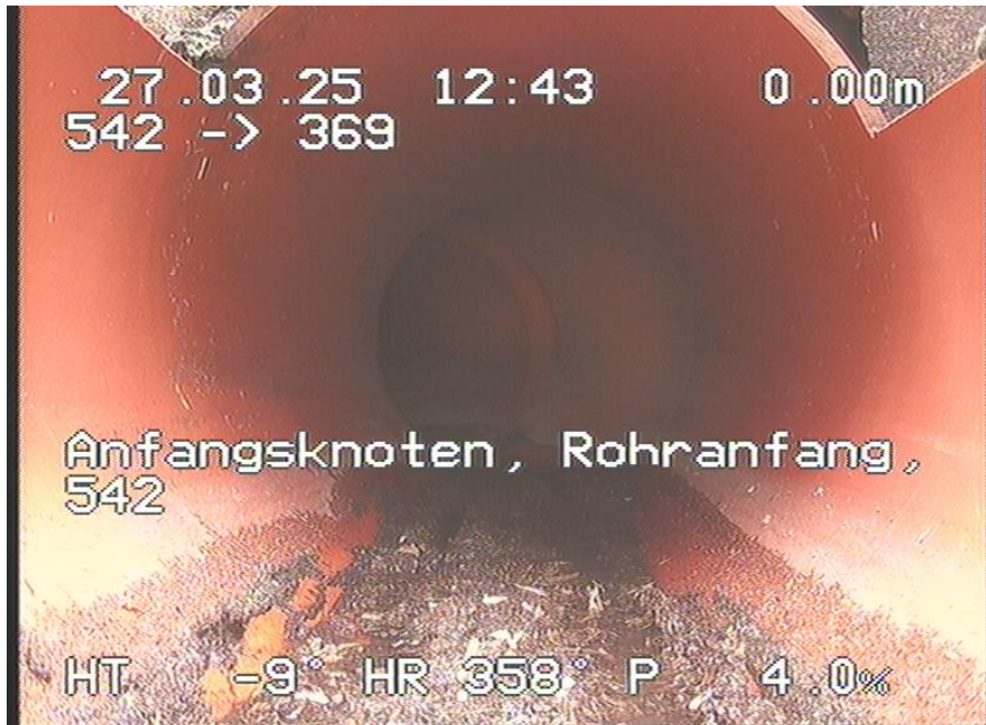
542-369_373.jpg, 00:00:00, 0.00m Anfangsknoten, Rohranfang, 542
