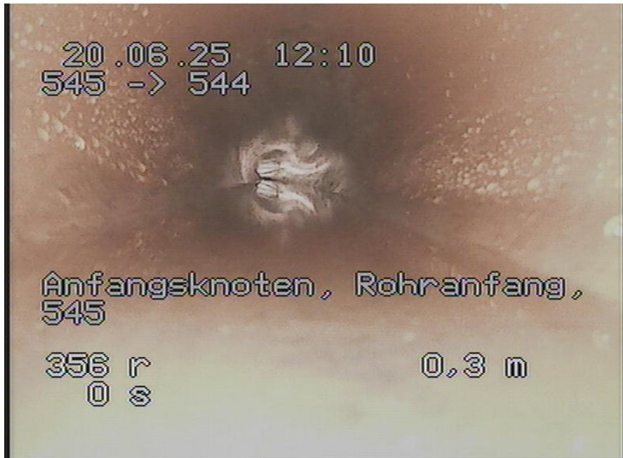
545-544_684.jpg, 00:00:00, 0.00m Anfangsknoten, Rohranfang, 545
