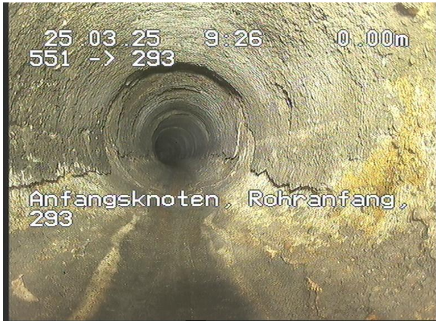
551-293_176.jpg, 00:00:00, 0.00m Anfangsknoten, Rohranfang, 293
