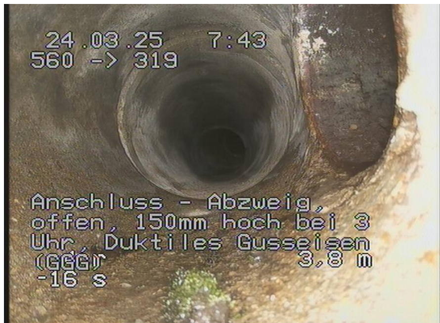
560-319_4.jpg, 00:00:55, 3.80m Anschluss - Abzweig, offen, 150mm hoch bei 3 Uhr, Duktils Gusseisen (GGG)
