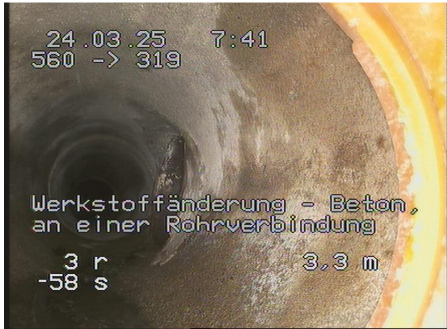
560-319_3.jpg, 00:00:36, 3.30m Werkstoffänderung - Beton, an einer Rohrverbindung
