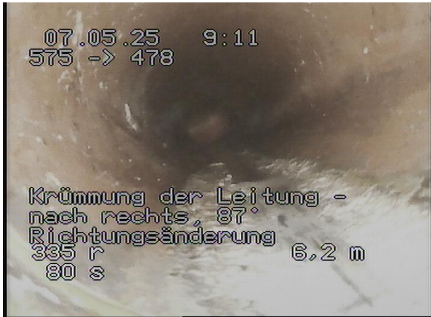
575-478_573.jpg, 00:01:36, 6.20m Krümmung der Leitung - nach rechts, 87° Richtungsänderung
