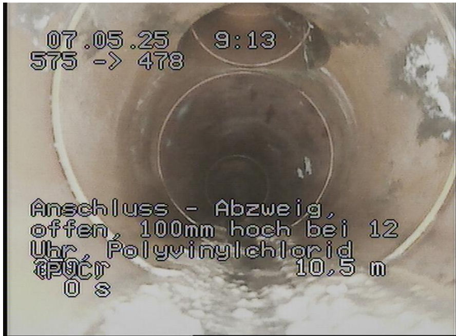
575-478_575.jpg, 00:02:39, 10.50m Anschluss - Abzweig, offen, 100mm hoch bei 12 Uhr, Polyvinylchlorid (PVC)
