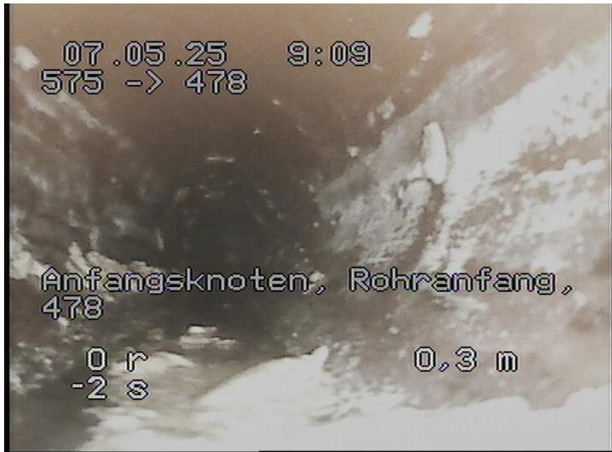
575-478_571.jpg, 00:00:00, 0.00m Anfangsknoten, Rohranfang, 478
