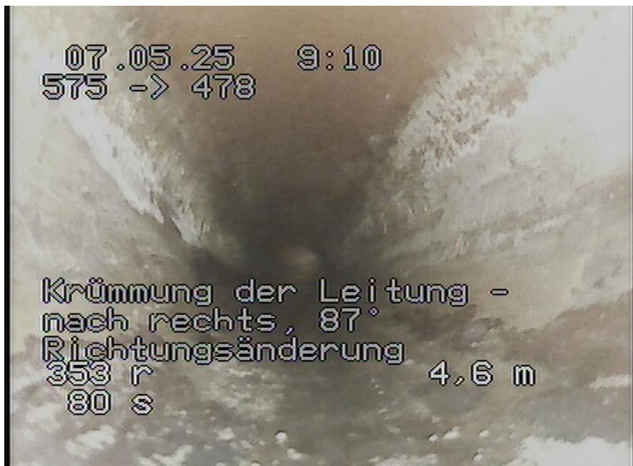
575-478_572.jpg, 00:01:06, 4.60m Krümmung der Leitung - nach rechts, 87° Richtungsänderung
