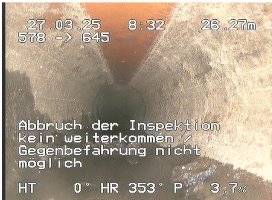
578-645_336.jpg, 00:04:07, 26.27m Abbruch der Inspektion / kein weiterkommen / Gegenbefahrung nicht möglich
