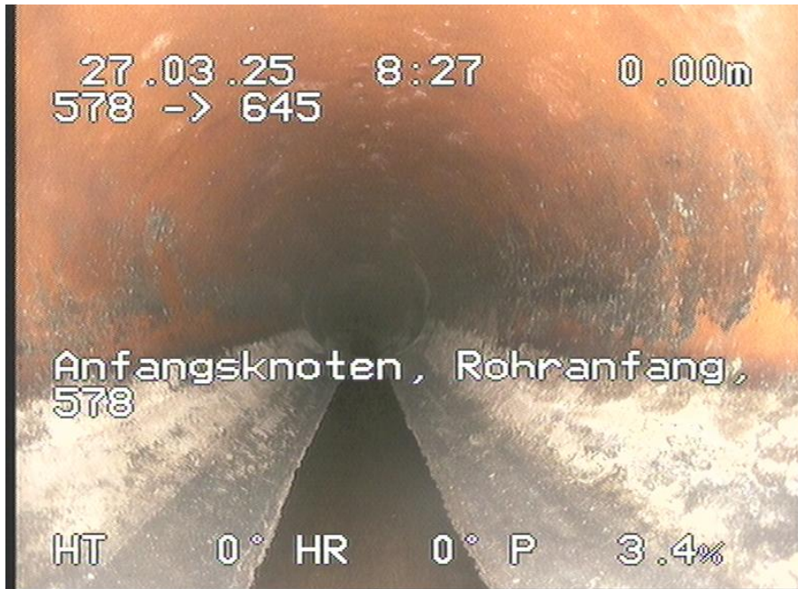
578-645_335.jpg, 00:00:00, 0.00m Anfangsknoten, Rohranfang, 578
