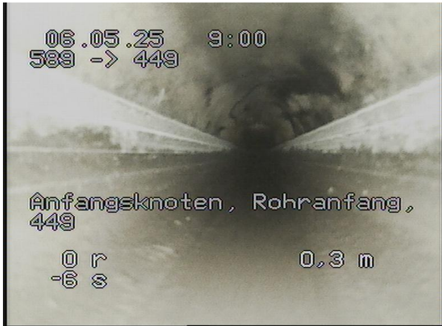
589-449_527.jpg, 00:00:00, 0.00m Anfangsknoten, Rohranfang, 449
