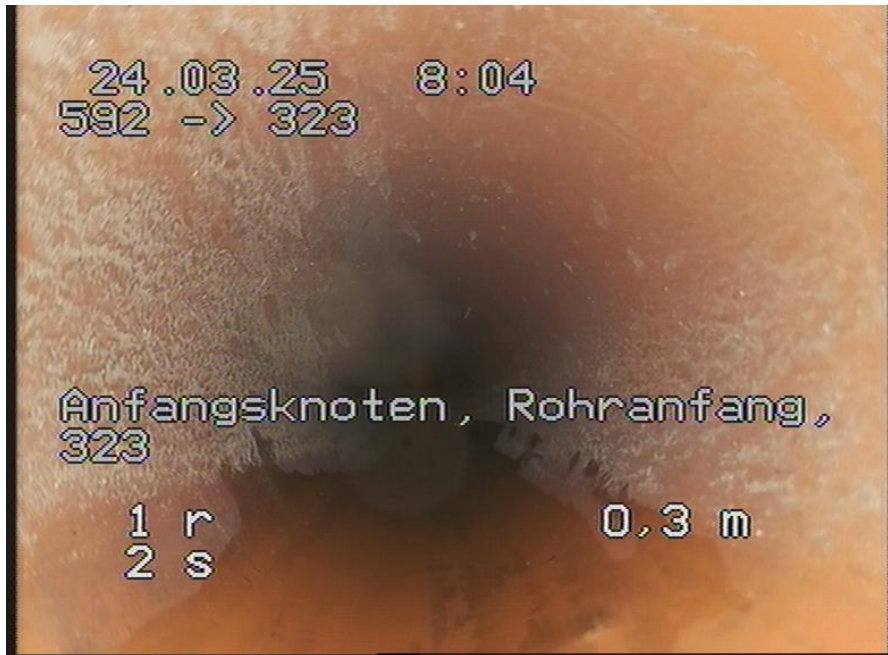
592-323_18.jpg, 00:00:00, 0.00m Anfangsknoten, Rohranfang, 323
