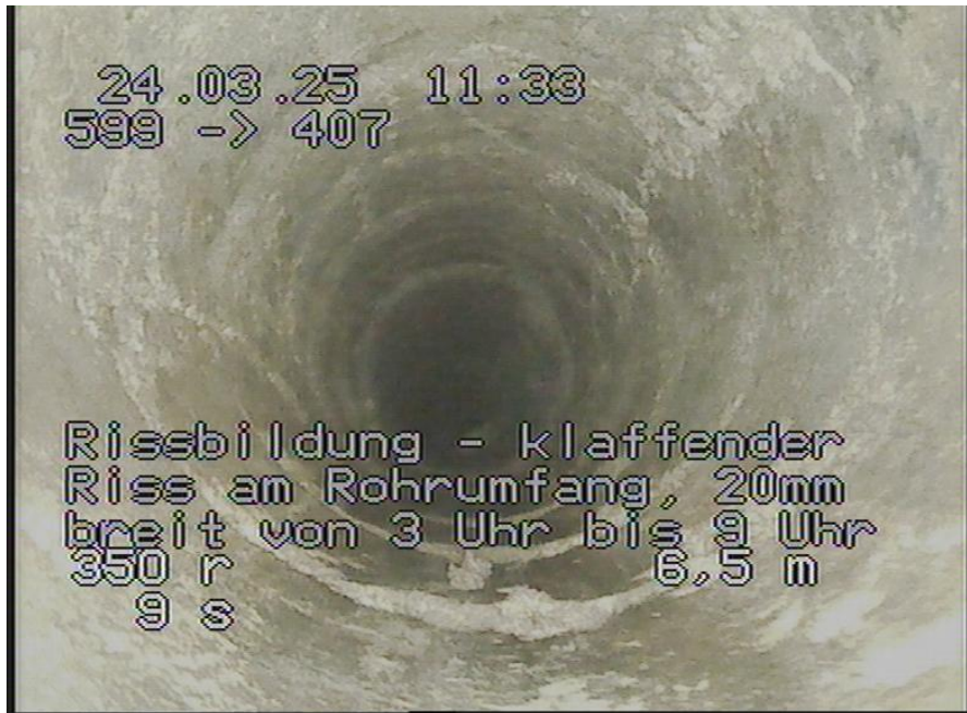
599-407_68.jpg, 00:01:16, 6.50m Rissbildung - klaffender Riss am Rohrumfang, 20mm breit von 3 Uhr bis 9 Uhr
