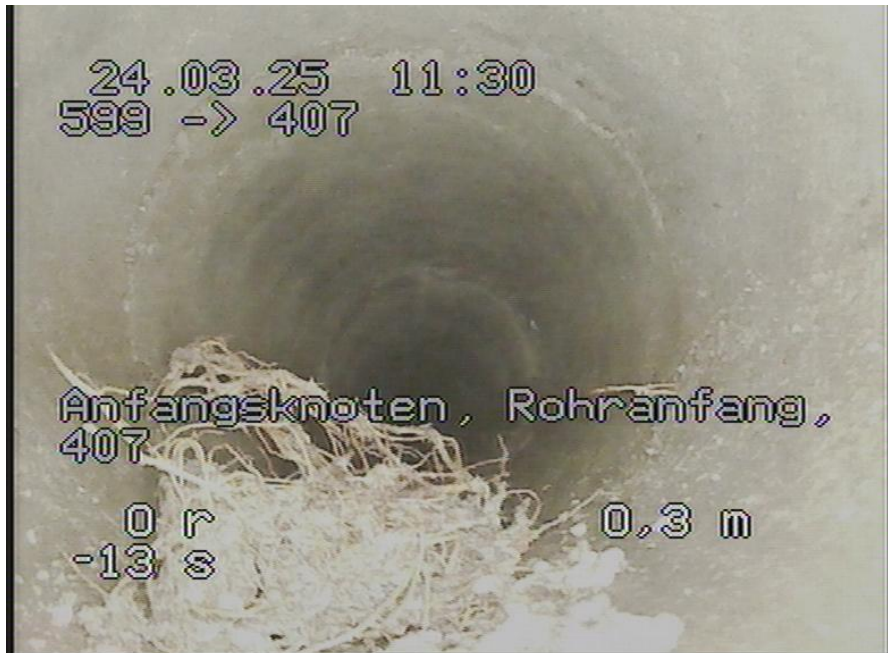
599-407_64.jpg, 00:00:00, 0.00m Anfangsknoten, Rohranfang, 407
