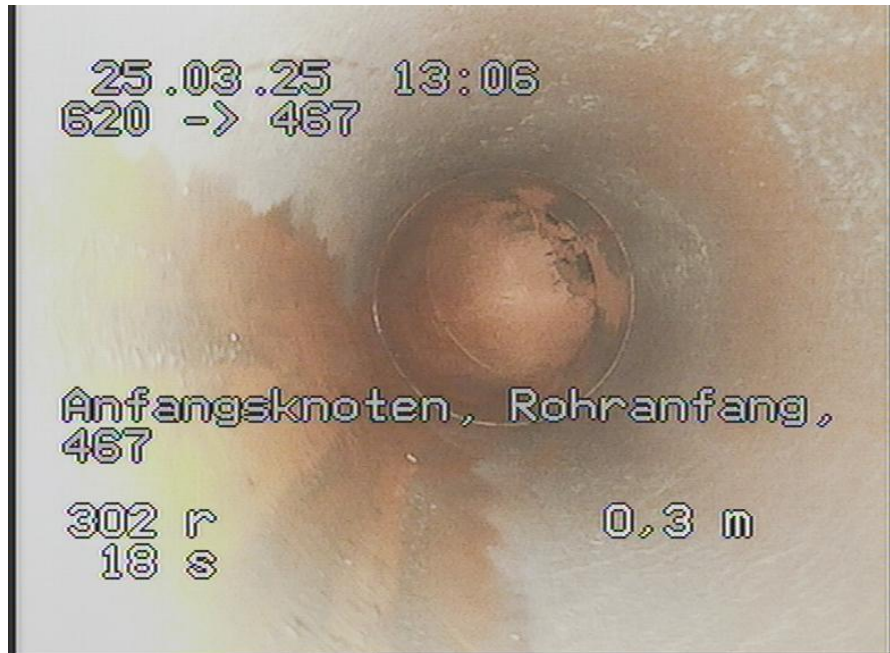
620-467_246.jpg, 00:00:00, 0.00m Anfangsknoten, Rohranfang, 467
