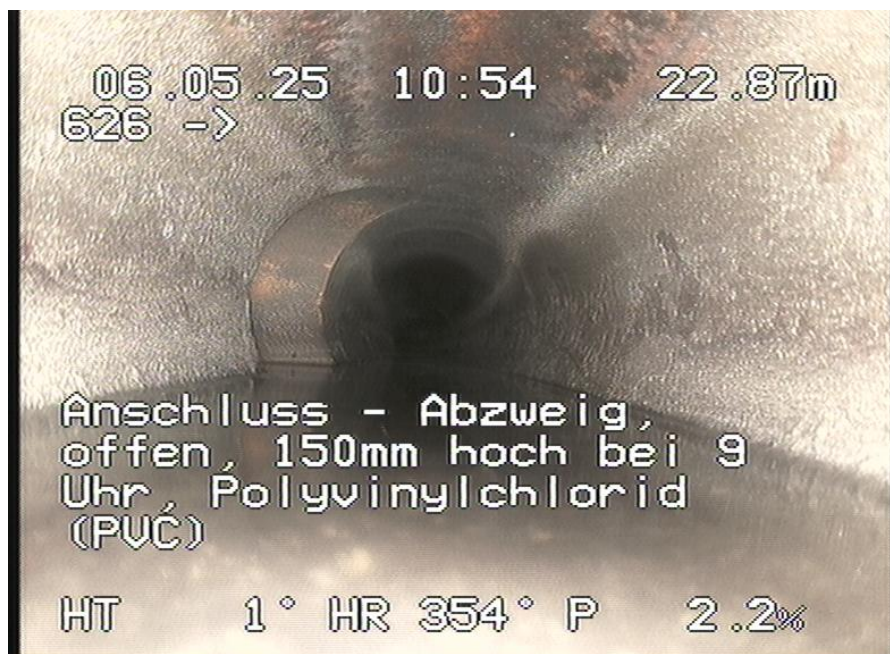
626- 553.jpg, 00:02:27, 22.87m Anschluss - Abzweig, offen, 150mm hoch bei 9 Uhr, Polyvinylchlorid (PVC)
