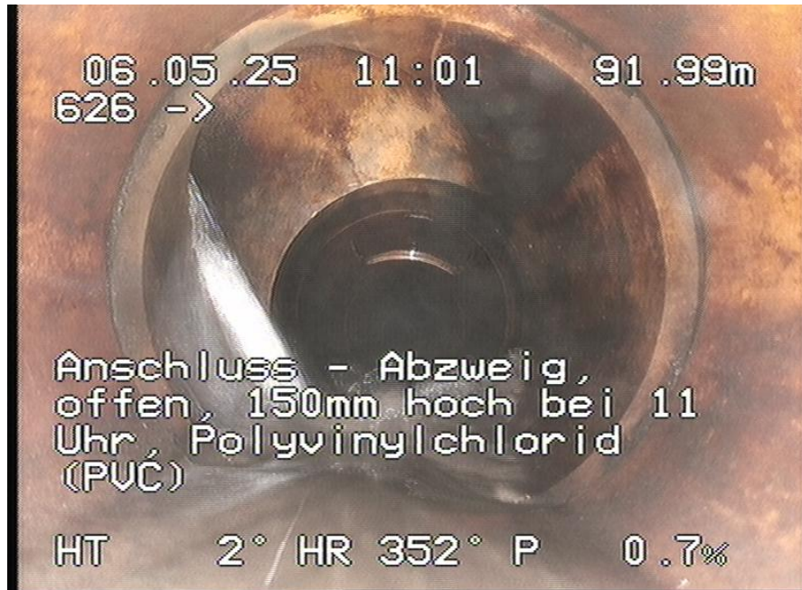
626- 554.jpg, 00:08:53, 91.99m Anschluss - Abzweig, offen, 150mm hoch bei 11 Uhr, Polyvinylchlorid (PVC)
