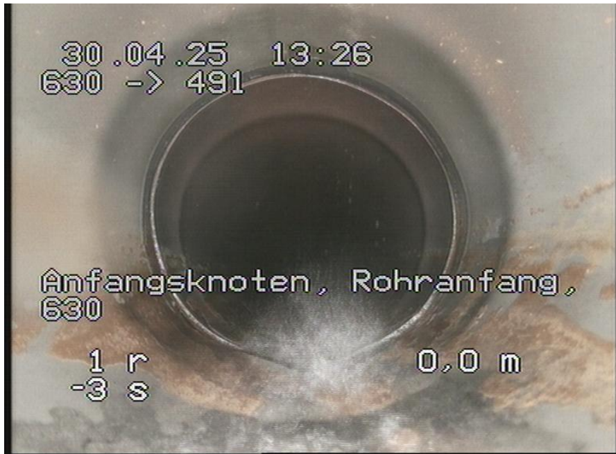
630-491_506.jpg, 00:00:00, 0.00m Anfangsknoten, Rohranfang, 630
