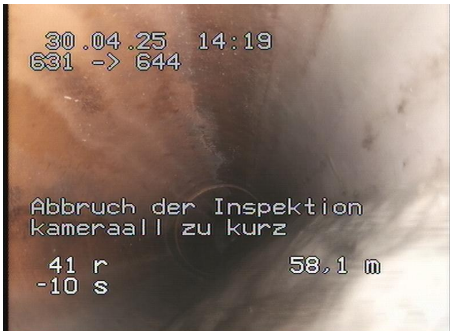
631-644_518.jpg, 00:03:08, 58.10m Abbruch der Inspektion / kameraall zu kurz
