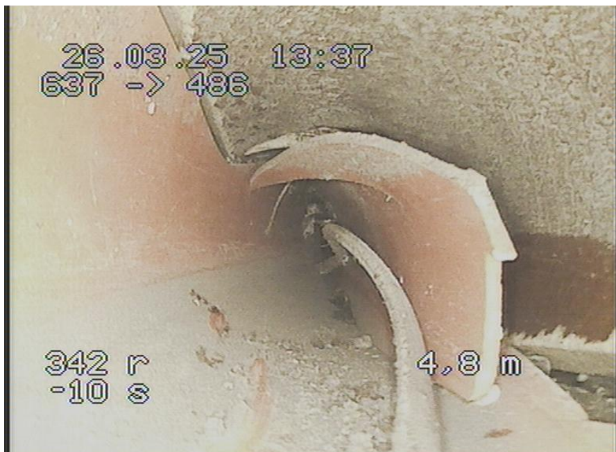
637-486_298.jpg, 00:01:11, 5.00m Abbruch der Inspektion / Einsturz
