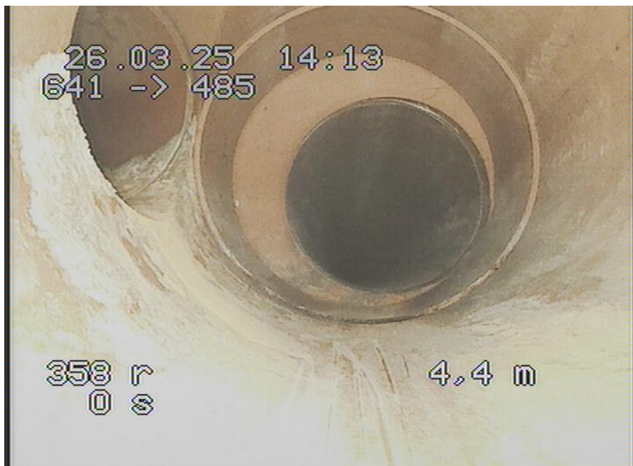
641-485_312.jpg, 00:00:28, 4.40m Anschluss - Abzweig, offen, 150mm hoch bei 10 Uhr, Polyvinylchlorid (PVC)
