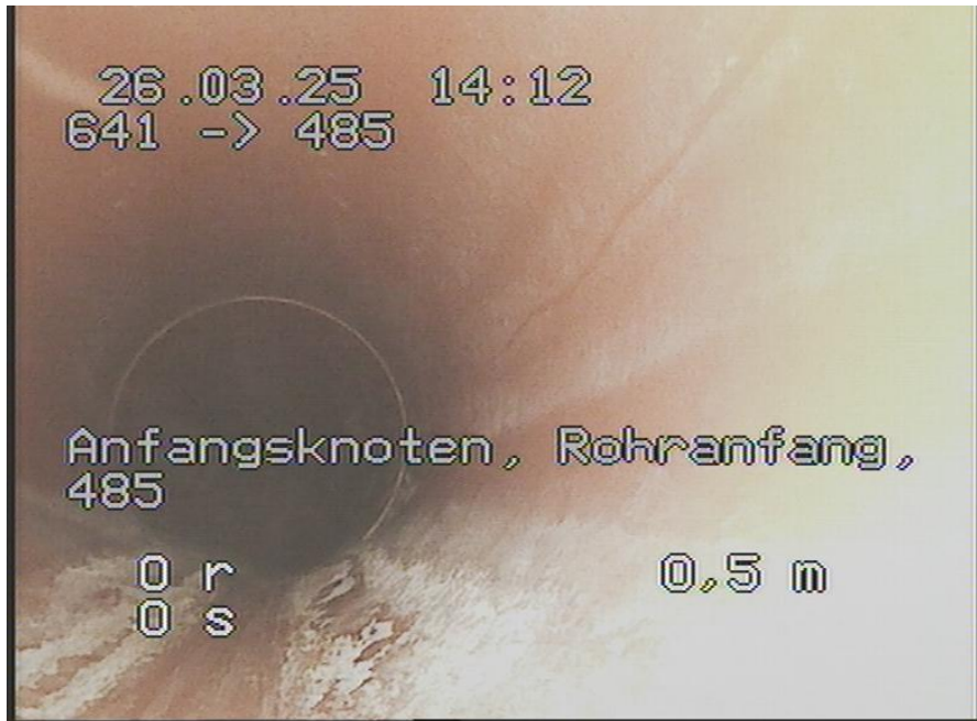
641-485_311.jpg, 00:00:00, 0.00m Anfangsknoten, Rohranfang, 485
