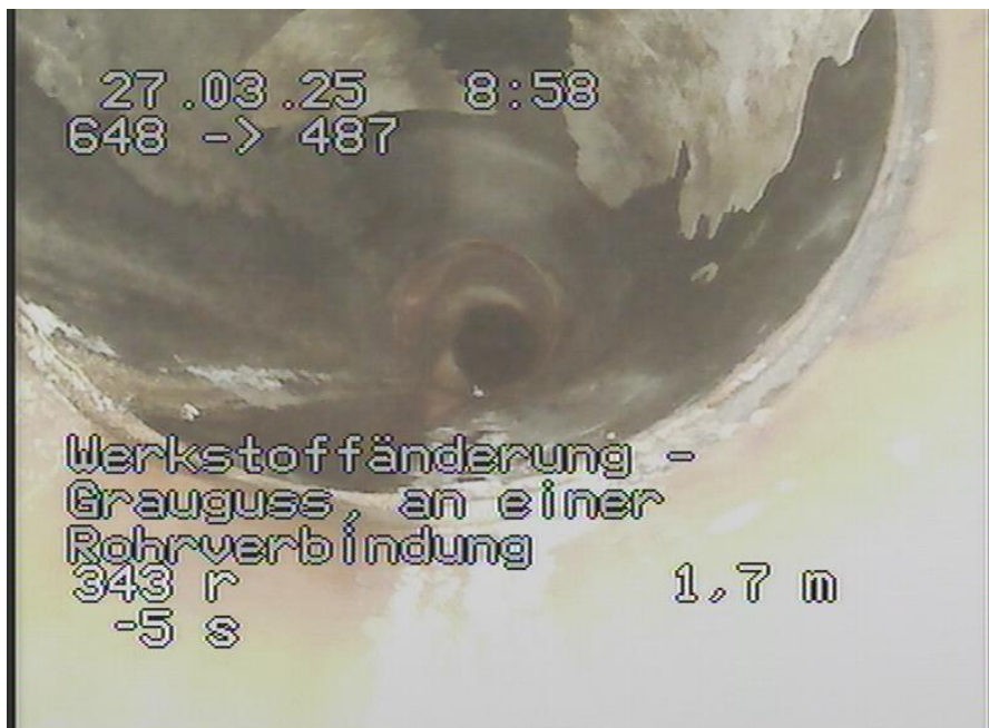
648-487_338.jpg, 00:00:45, 1.70m Werkstoffänderung - Grauguss, an einer Rohrverbindung
