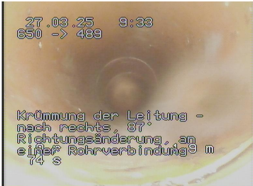
650-489_360.jpg, 00:00:58, 1.90m Krümmung der Leitung - nach rechts, 87° Richtungsänderung, an einer Rohrverbindung
