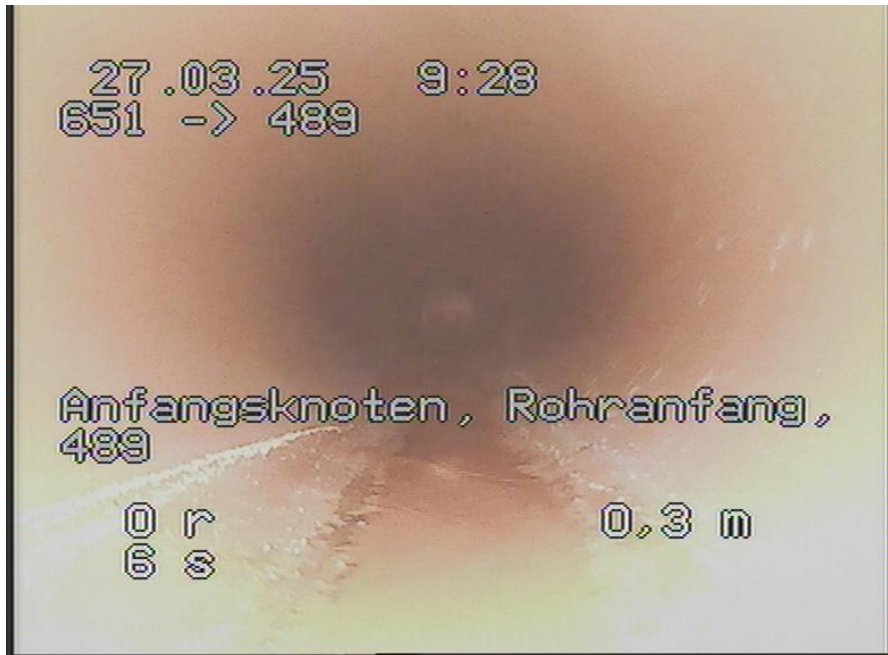
651-489_354.jpg, 00:00:00, 0.00m Anfangsknoten, Rohranfang, 489
