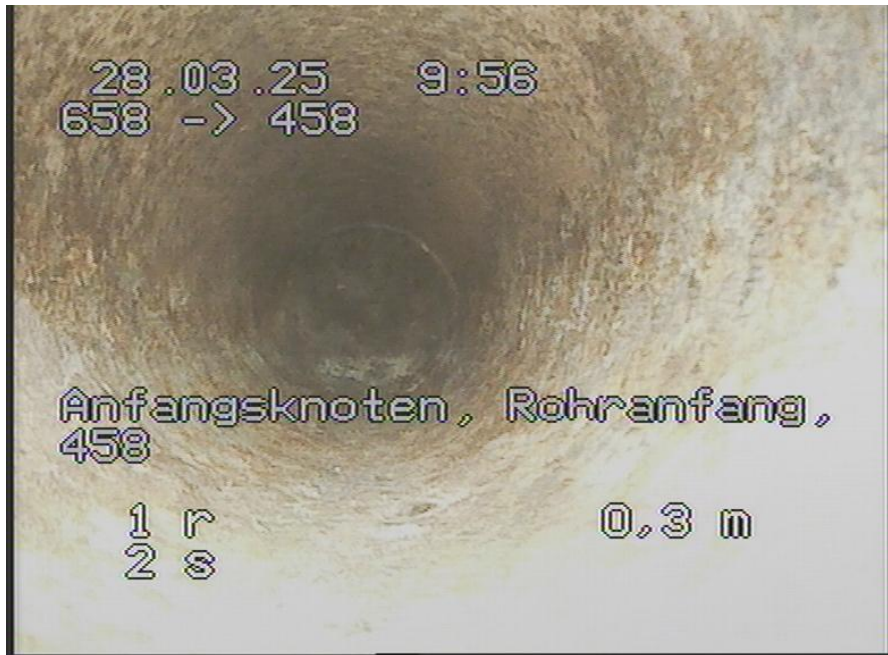
658-458_386.jpg, 00:00:00, 0.00m Anfangsknoten, Rohranfang, 458
