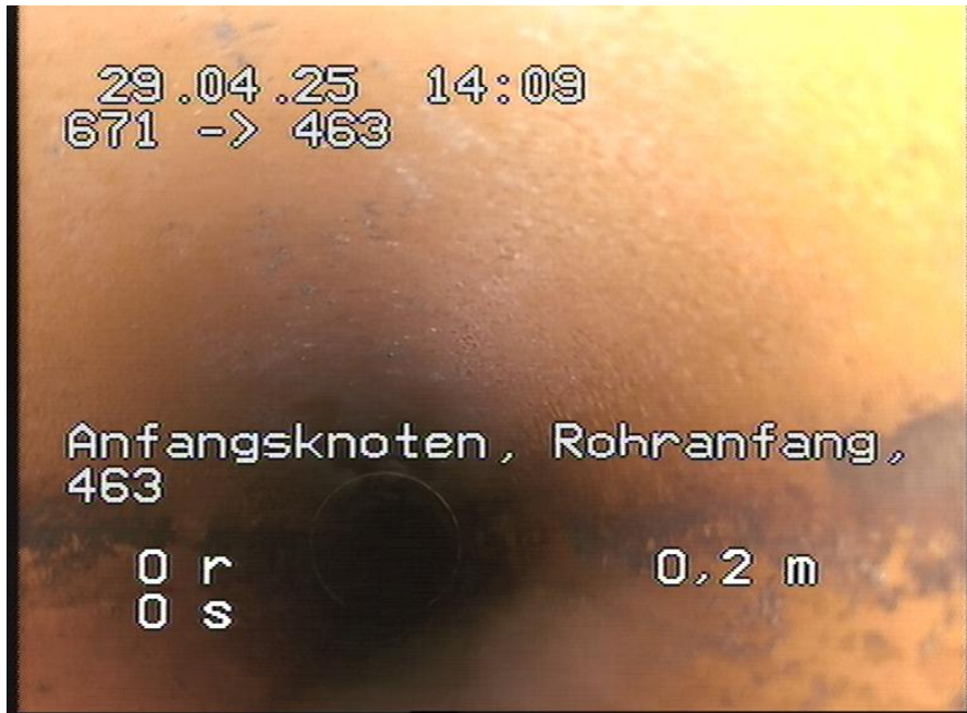
671-463_469.jpg, 00:00:00, 0.00m Anfangsknoten, Rohranfang, 463
