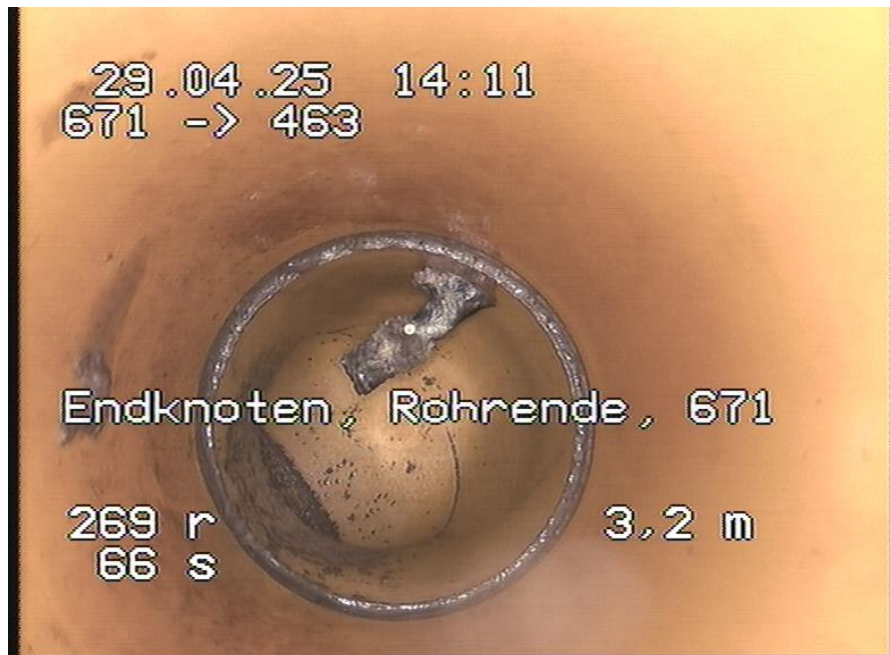
671-463_471.jpg, 00:00:48, 3.20m Endknoten, Rohrende, 671
