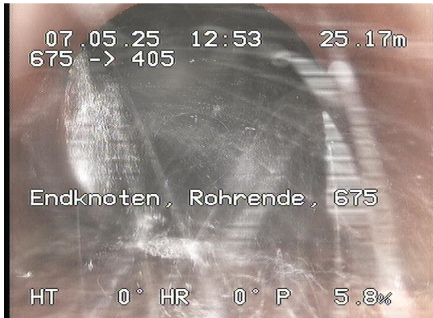
675-405_608.jpg, 00:03:29, 25.17m Endknoten, Rohrende, 675
