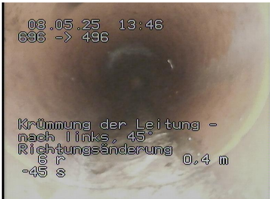
696-496_658.jpg, 00:00:18, 0.40m Krümmung der Leitung - nach links, 45° Richtungsänderung
