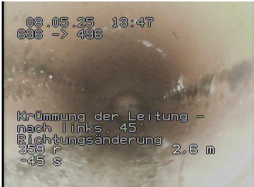
696-496_659.jpg, 00:00:37, 2.60m Krümmung der Leitung - nach links, 45° Richtungsänderung
