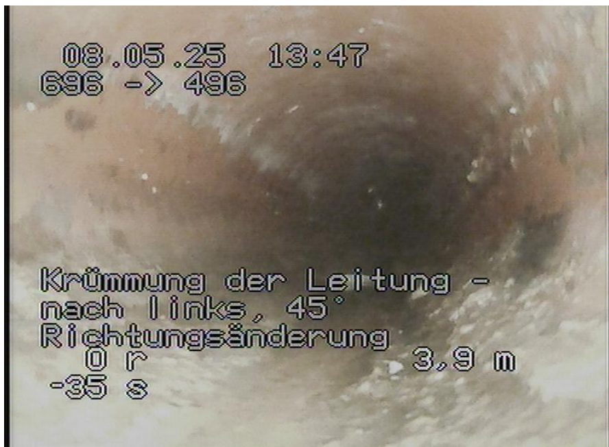
696-496_660.jpg, 00:01:03, 3.90m Krümmung der Leitung - nach links, 45° Richtungsänderung
