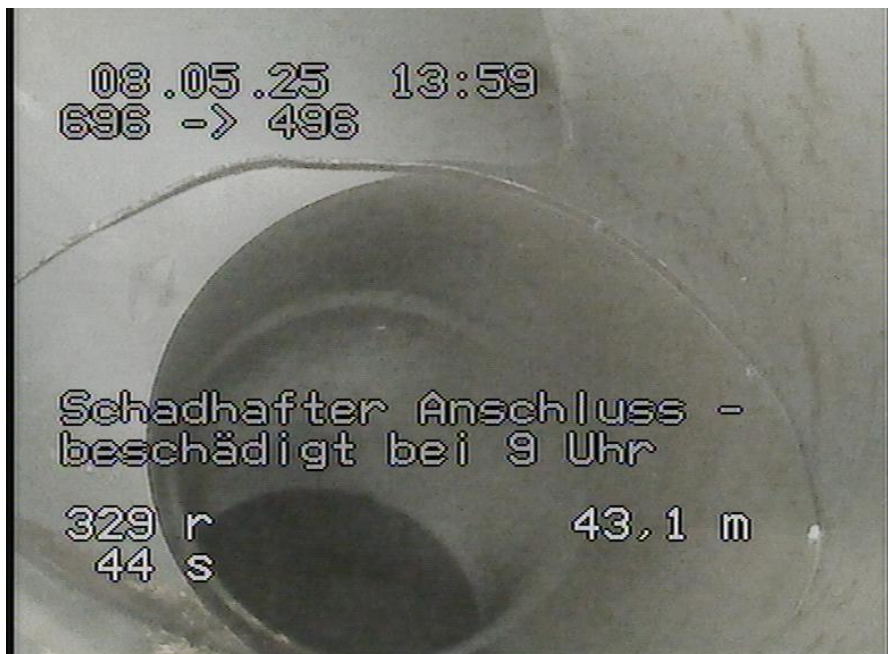
696-496_670.jpg, 00:06:46, 43.10m Schadhafter Anschluss - beschädigt bei 9 Uhr
