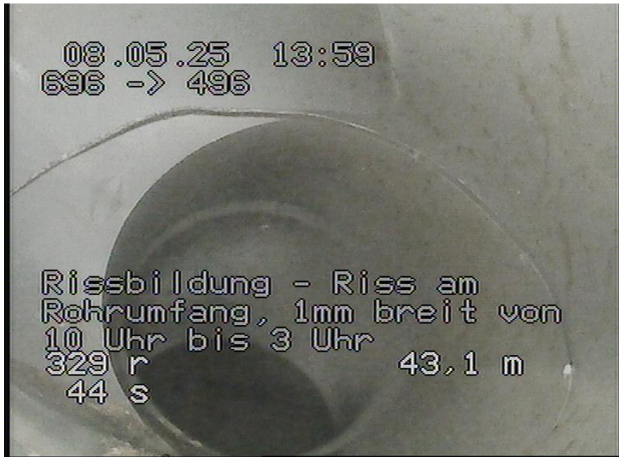
696-496_671.jpg, 00:06:52, 43.10m Rissbildung - Riss am Rohrumfang, 1mm breit von 10 Uhr bis 3 Uhr
