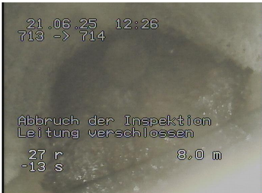
713-714_760.jpg, 00:01:09, 8.00m Endknoten, Rohrende, 714 / Rohröffnung verschlossen
