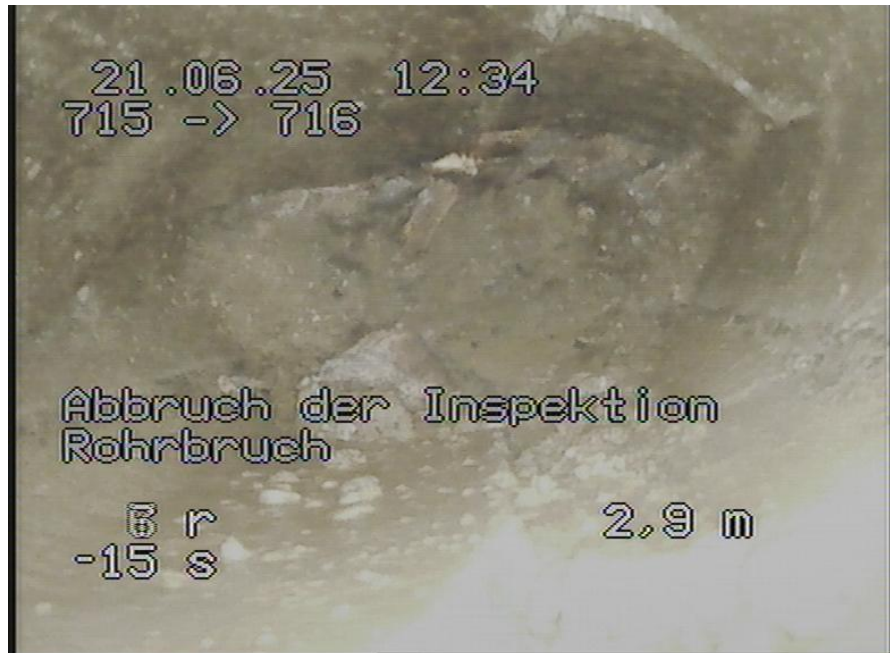
715-716_765.jpg, 00:00:35, 2.90m Endknoten, Rohrende, 716 / Rohröffnung verschlossen
