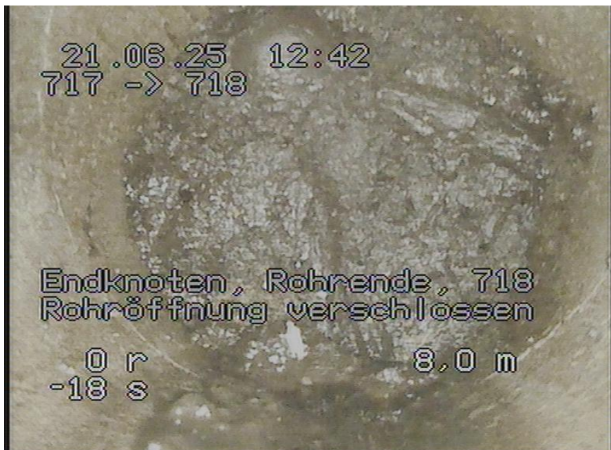
717-718_769.jpg, 00:00:35, 8.00m Endknoten, Rohrende, 718 / Rohröffnung verschlossen
